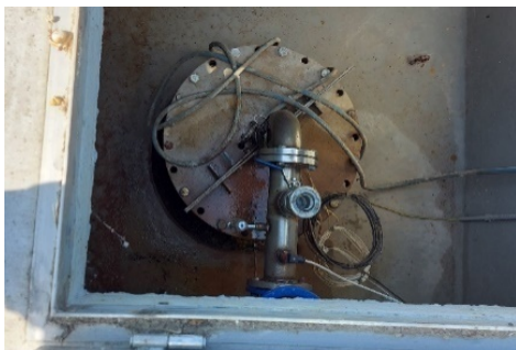
3. ábra Szinkron szivattyú elhelyezkedése
