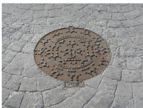
10.7. „Nagyon nem csúszós” aknafedlap
